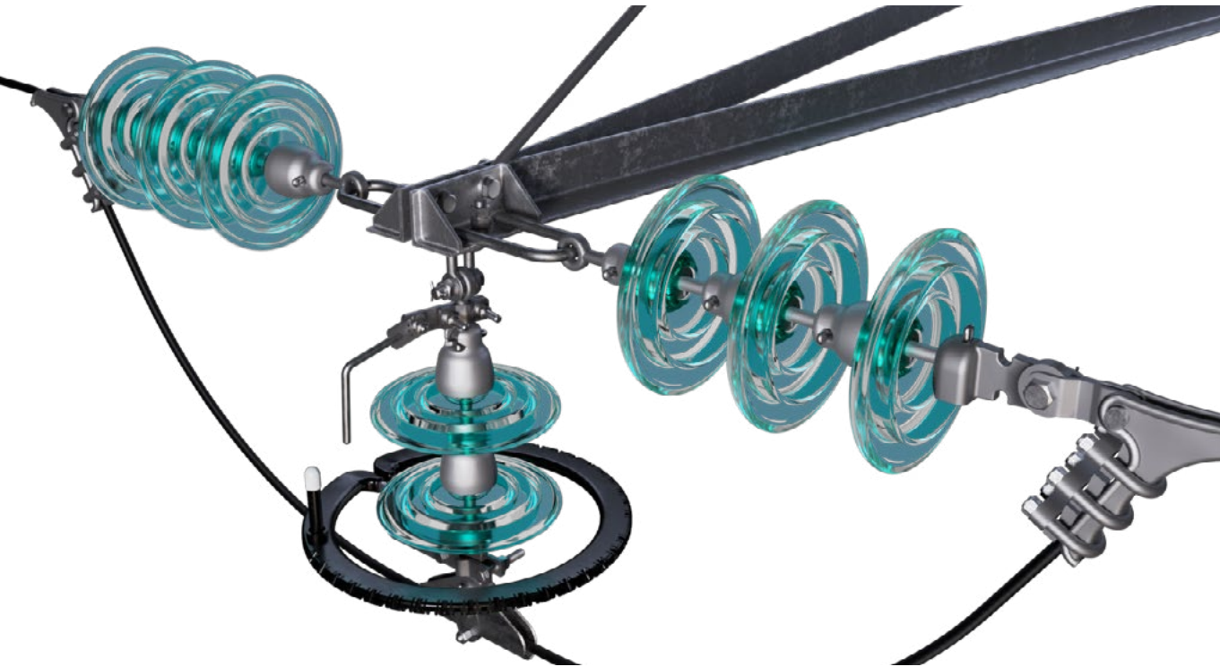
Рис. 16. Установка РМКЭ-20 совместно с натяжной стеклянной изоляцией
